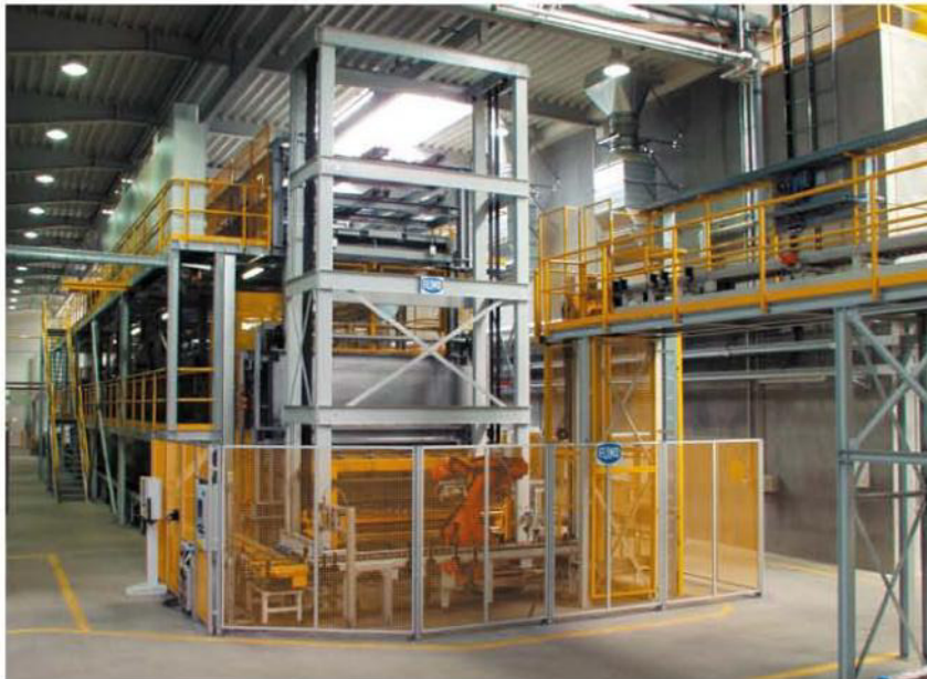
Warmauslagerungslinie in modularem Aufbau mit externer Fördertechnik für Motorblöcke
