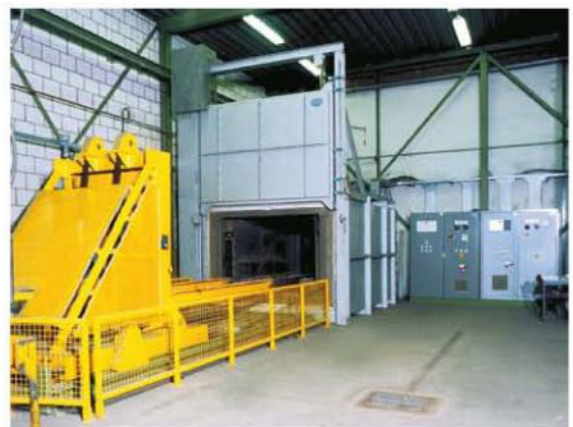
Aushärtelinie mit Chargenofen, Wasserabschreckbecken und Fördertechnik für Präzisionsgussteile
